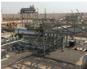
Garraf Gas Treatment Unit 발 주 처 : PETRONAS Carigali Iraq Holing B.V. 수행범위 : EPC of Gas treatment Unit for Oil-gas Separation 위 치 : 가라프 유전, 이라크 수행기간 : 2013. 11 ~ 2017. 03
